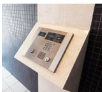
オートロック 設置
